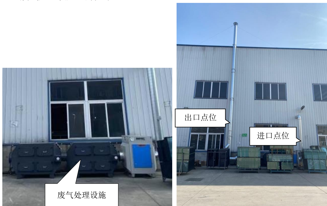
图 3-2 打胶、密封胶废气处理设施照片
