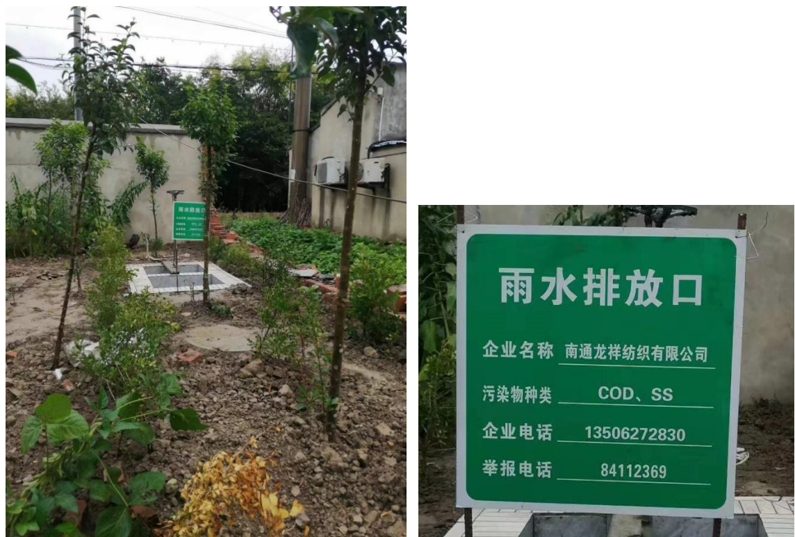
图 3-6 雨水排口及标志牌照片
