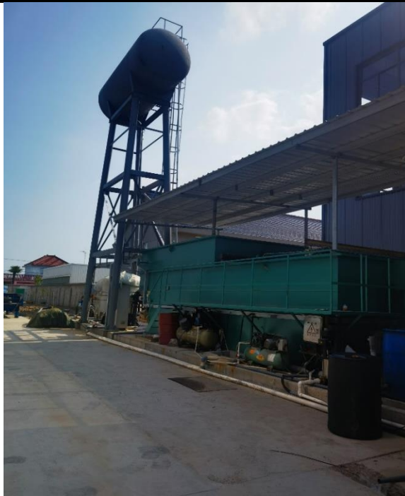
图 3-2 织造废水处理设施照片
