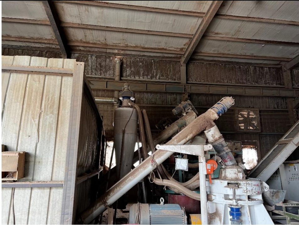
废气进口照片
