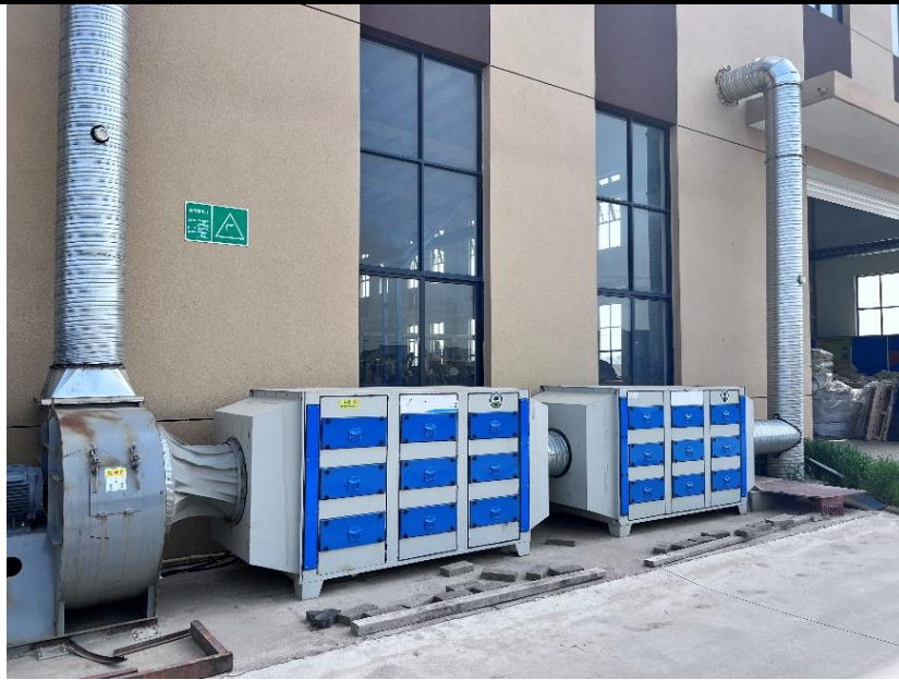
图 3-3 挤塑废气、喷码废气二级活性炭吸附装置照片
