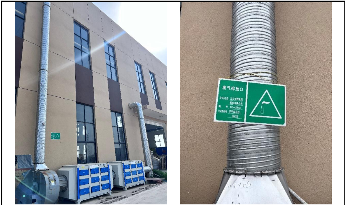
图 3-8 挤塑、喷码废气排气筒及标志牌照片
