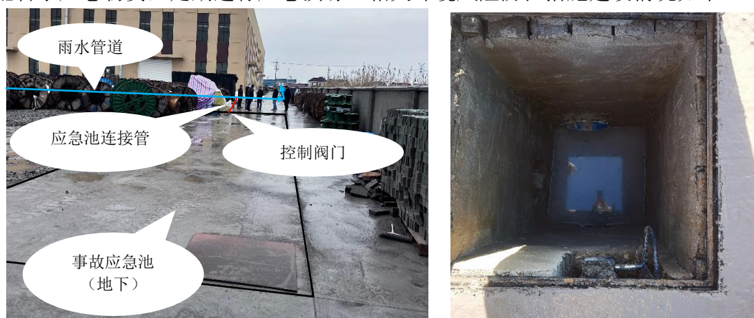
图 3-6 事故应急池及控制闸阀照片
