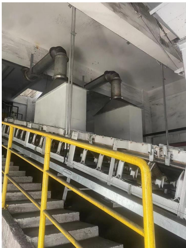
图4.1-9 转运站粉尘布袋除尘装置
