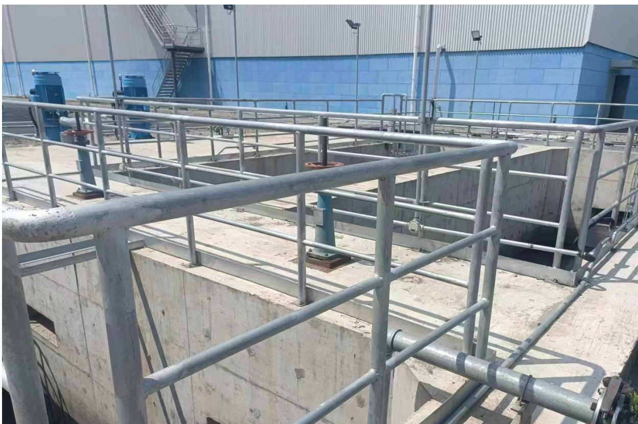
图4.1-2 煤水处理设施照片
