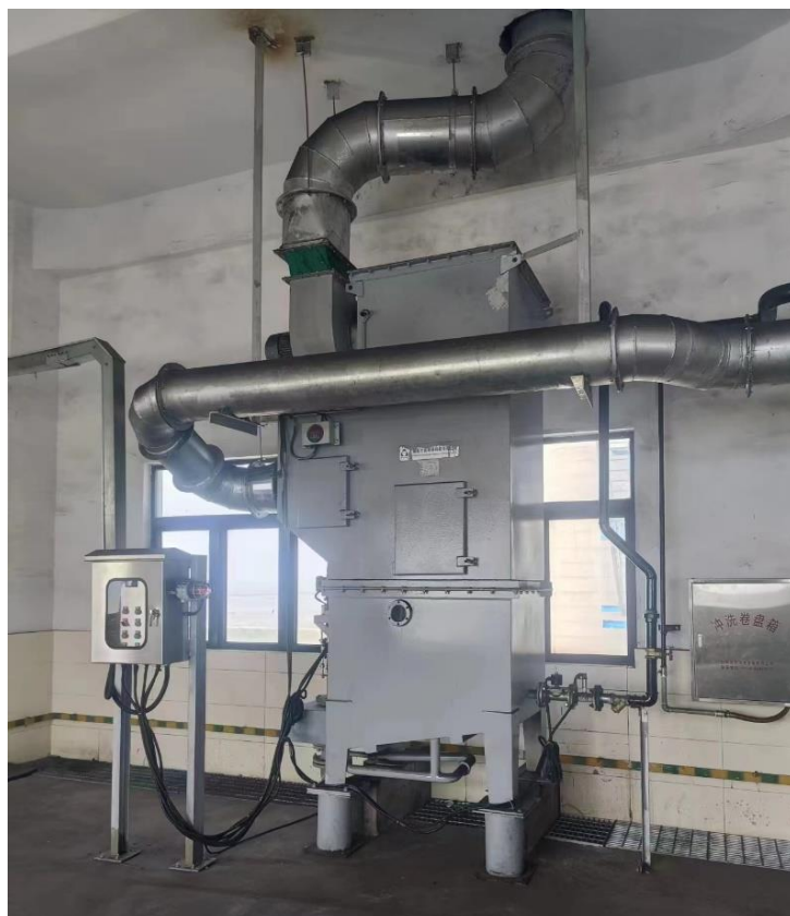
图4.1-11 煤仓间粉尘布袋除尘装置
