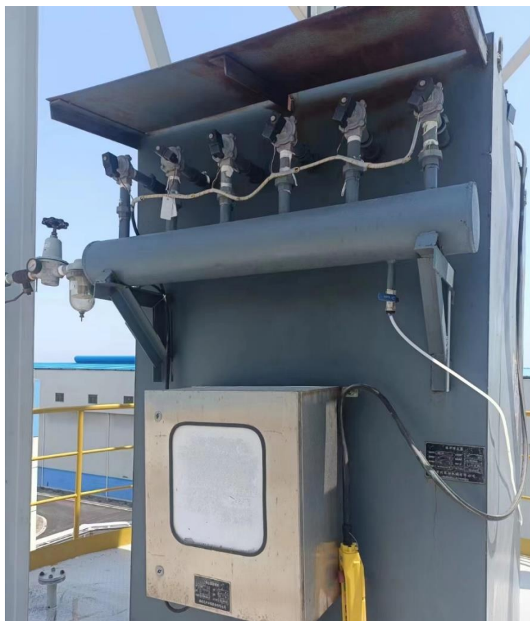
图4.1-14 石灰石料粉仓粉尘布袋除尘装置
