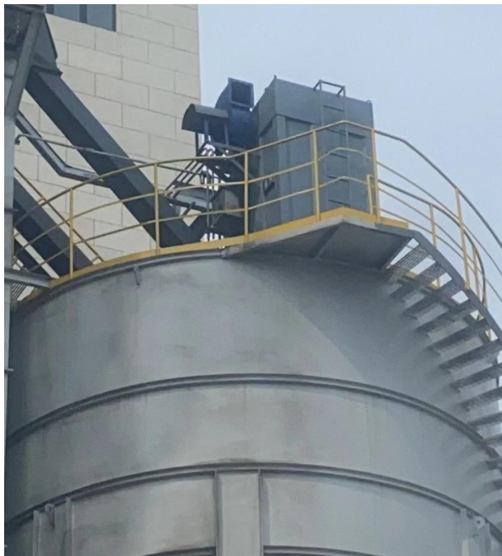
图4.1-13 渣仓粉尘布袋除尘装置
