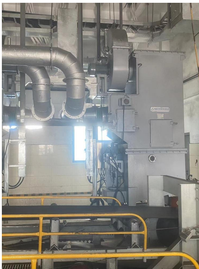
图4.1-10 碎煤室粉尘布袋除尘装置
