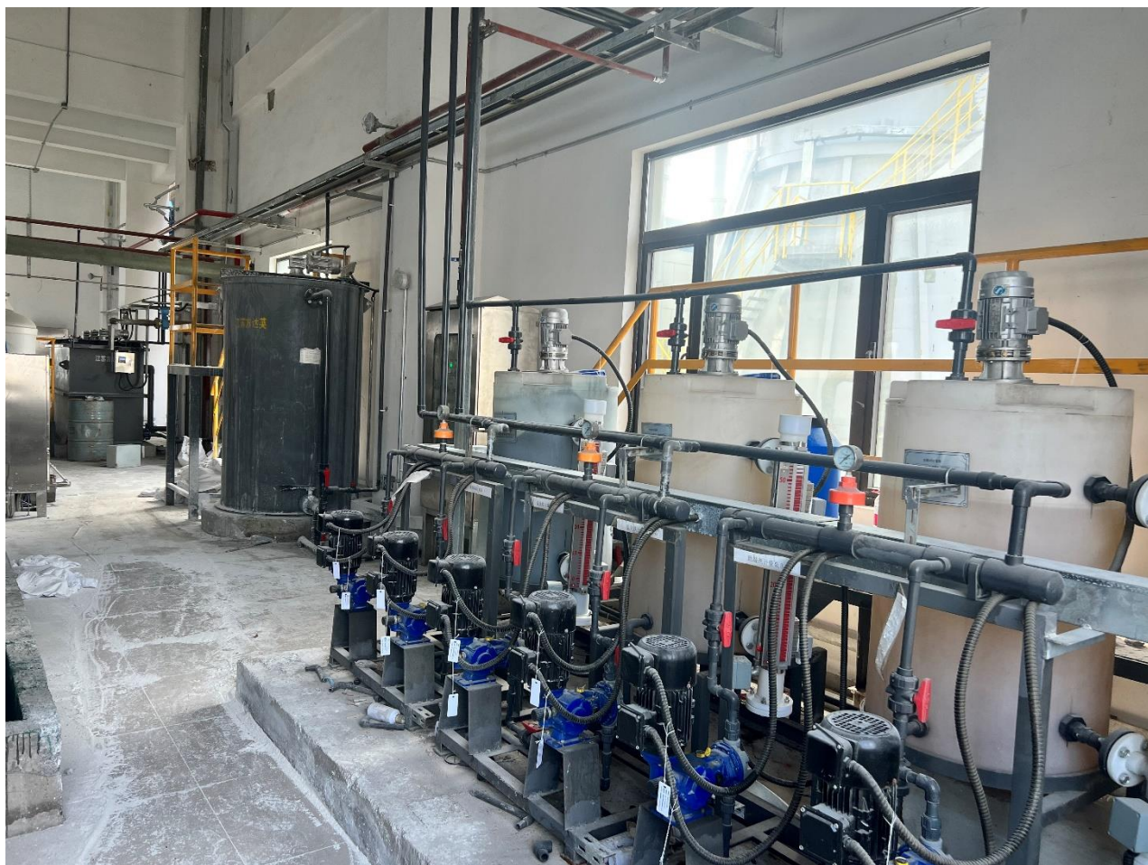
图4.1-5 脱硫废水处理设施照片
