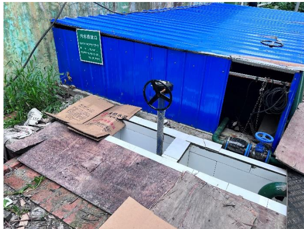
图 3-4 污水排口规范化照片
