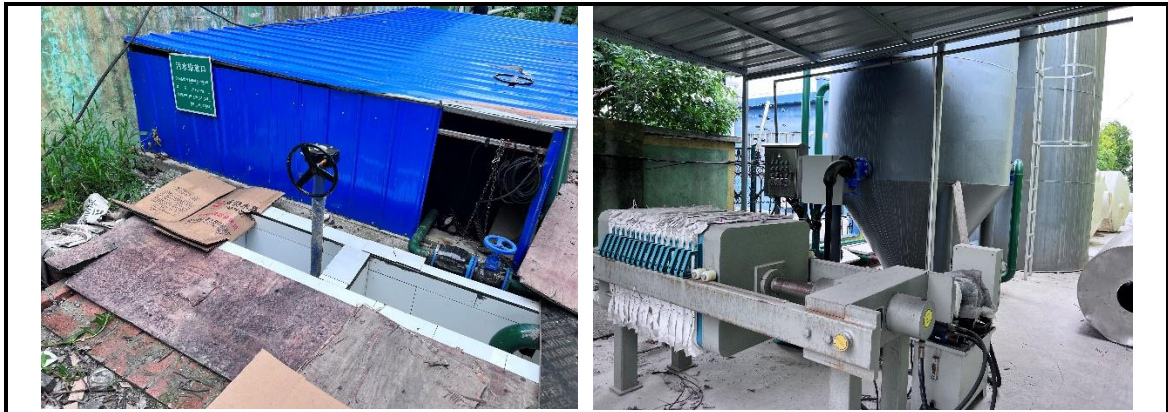
图 3-2 隔油调节池+SBR 反应池照片
