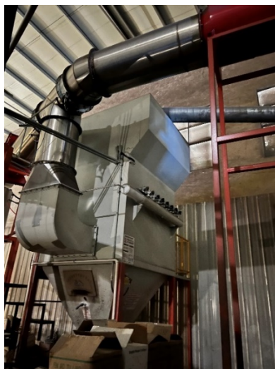
喷塑废气处理设施
