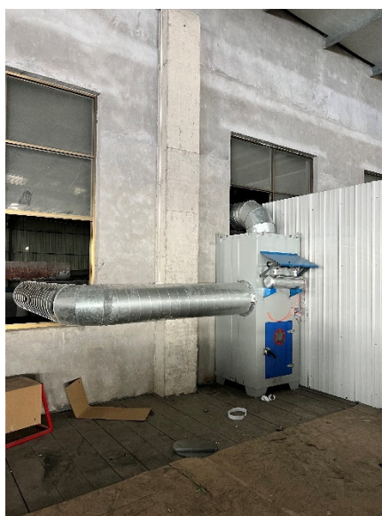
燃烧废气处理设施
