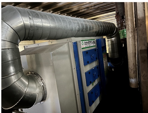
烘干废气处理设施
