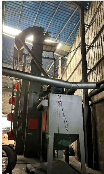
抛丸废气处理设施
