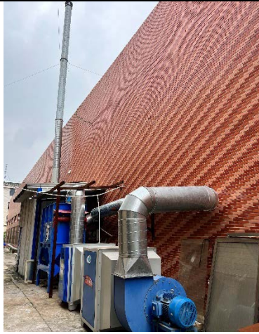
配料、密炼、开炼、包胶、配料、包覆废气处理设施 图 3-2 项目废气处理设施照片
