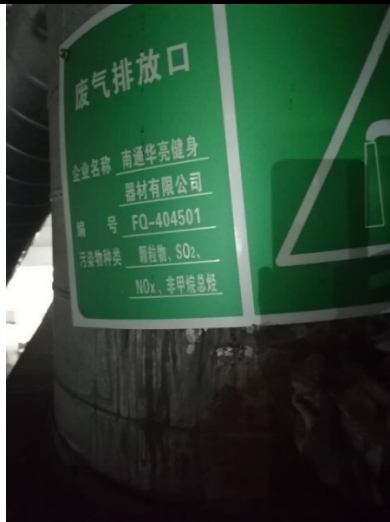
抛丸、燃烧废气、焊接废气 1#排气筒
