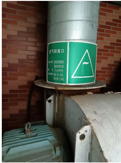
喷塑废气 9#排气筒
