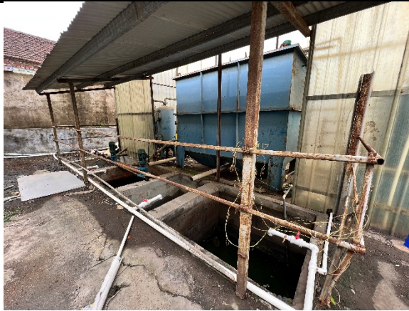
图 3-5 项目废水处理设施照片
