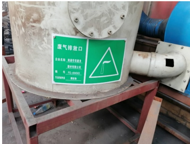
切割废气 3#排气筒
