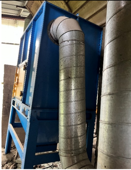
焊接废气处理设施
