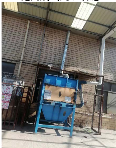
切割废气处理设施
