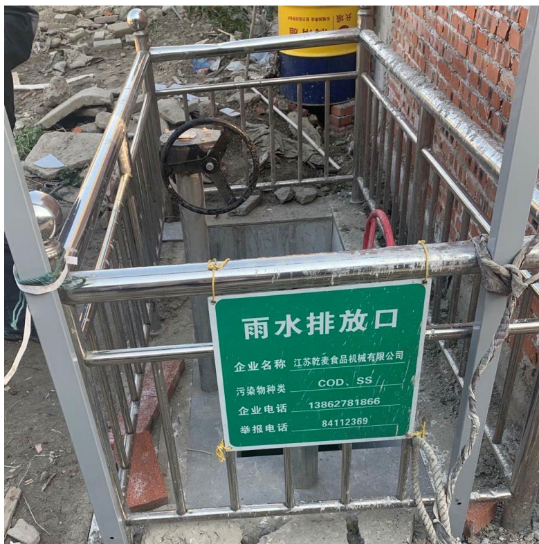
雨水排口及标志牌照片
