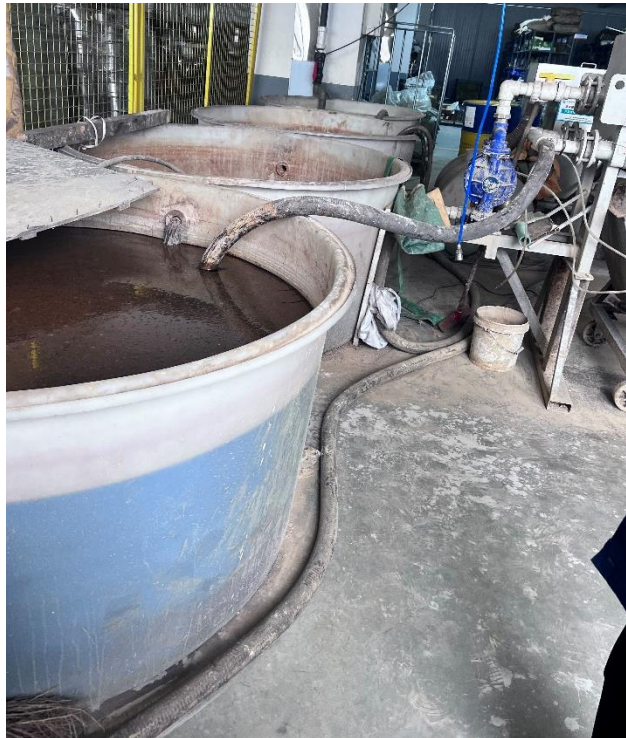
图4.1-2 水帘废水、水喷淋废水处理设施照片
