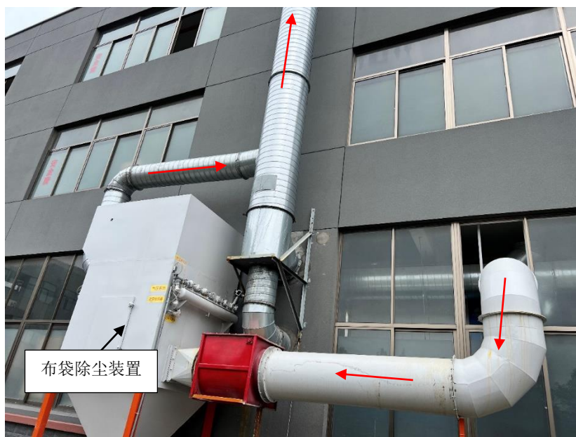
图4.1-10 喷塑废气布袋除尘装置照片
