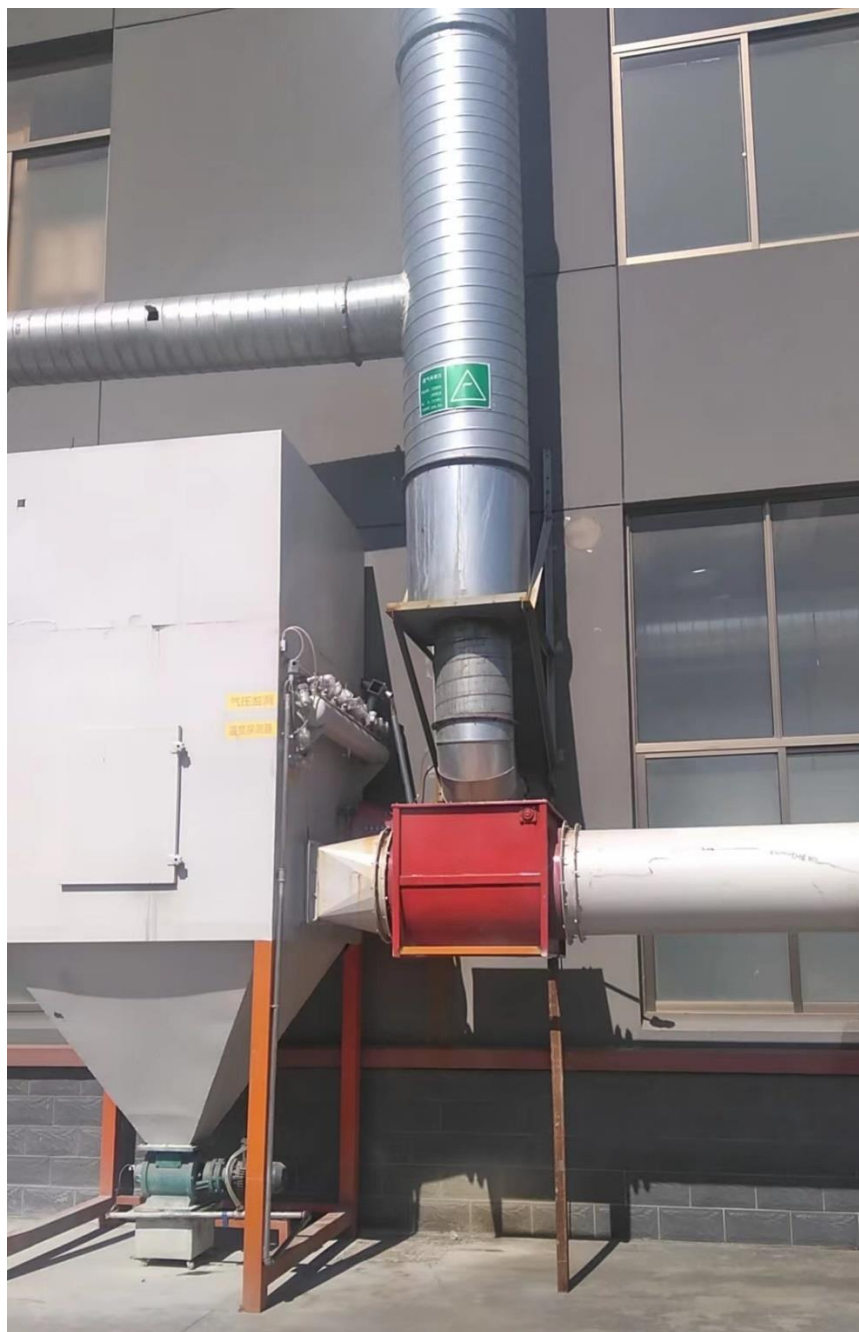
1#排气筒标志牌
