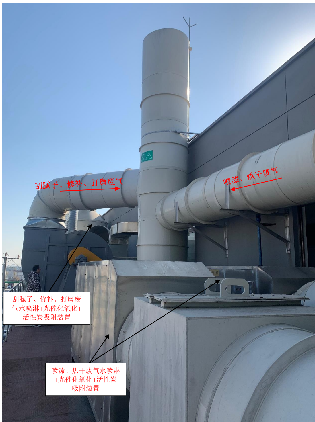
图4.1-15 刮腻子、修补、打磨、喷漆、烘干废气水喷淋+光催化氧化+活性炭吸附装置照片
