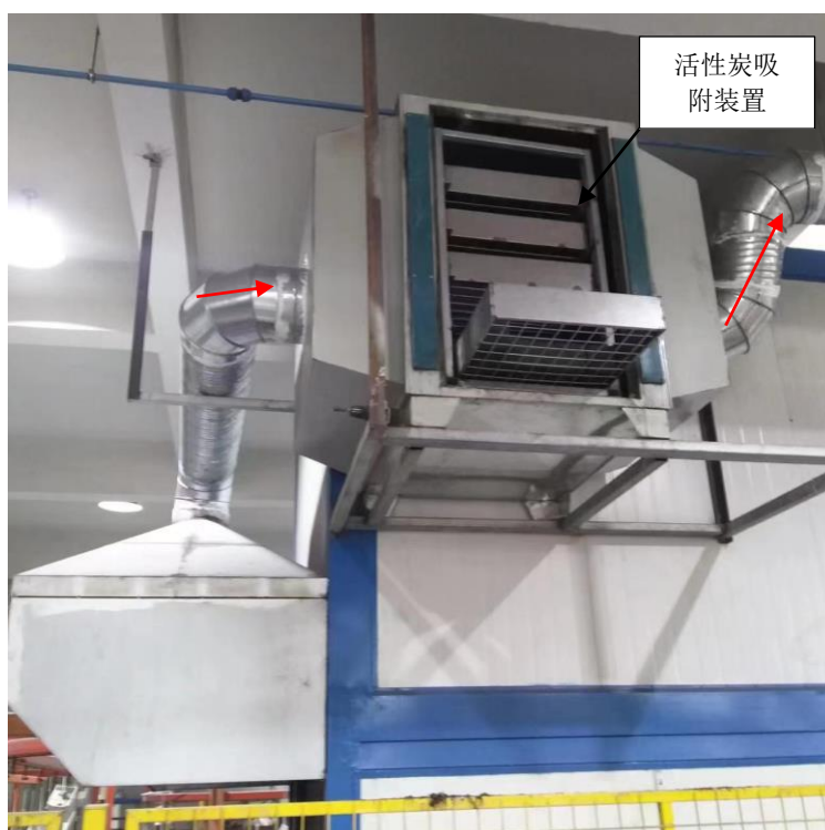
图4.1-12 加热流平废气活性炭吸附装置照片
