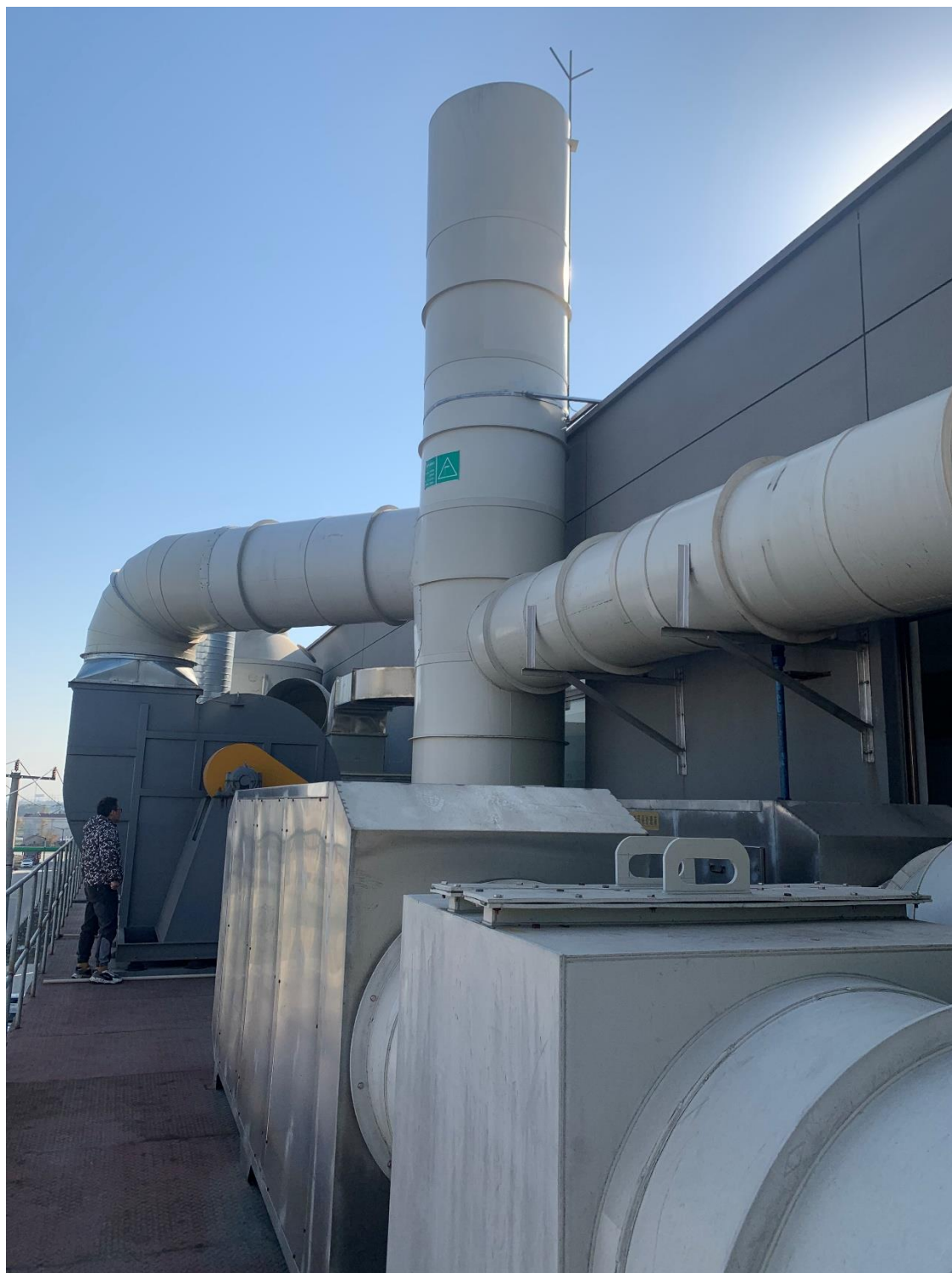
3#排气筒标志牌
