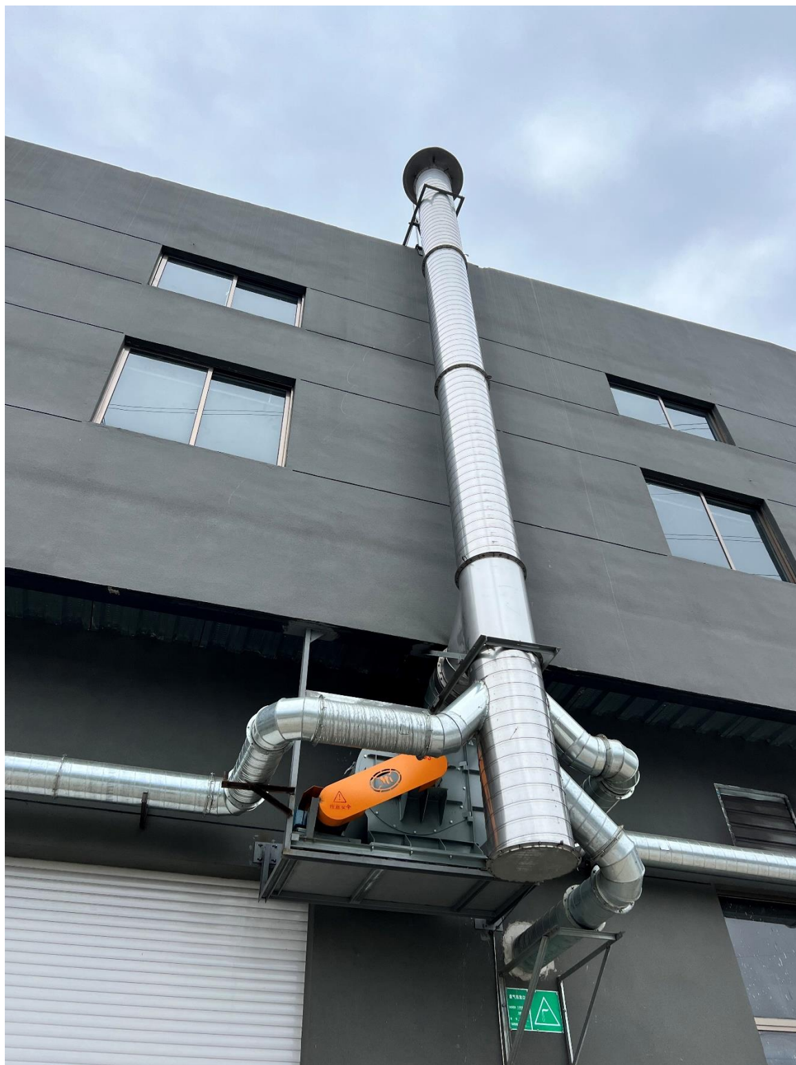
2#排气筒标志牌
