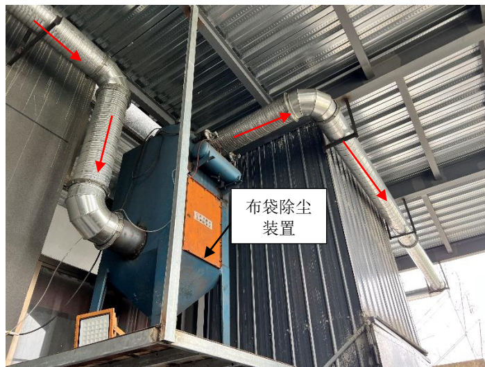
图4.1-4 熔化废气布袋除尘装置照片
