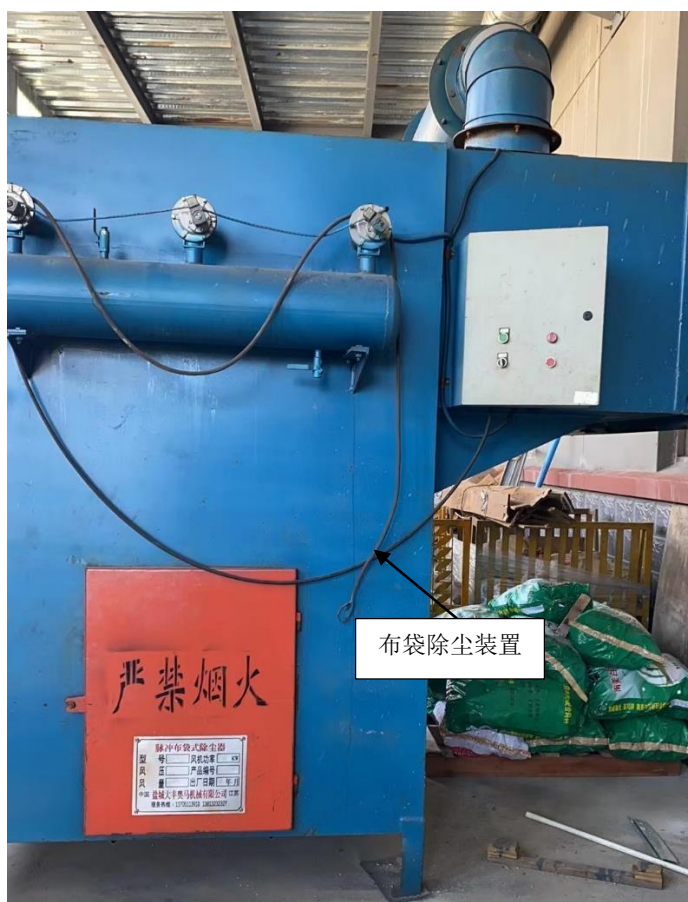
图4.1-7 清砂废气布袋除尘装置照片
