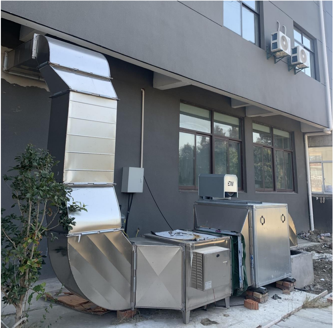
图4.1-16 食堂油烟净化装置照片
