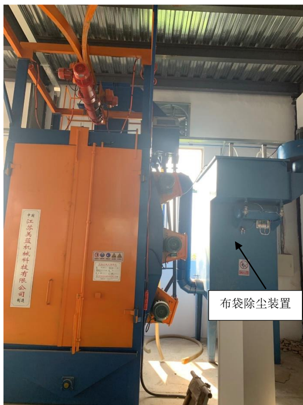
图4.1-8 喷砂废气布袋除尘装置照片
