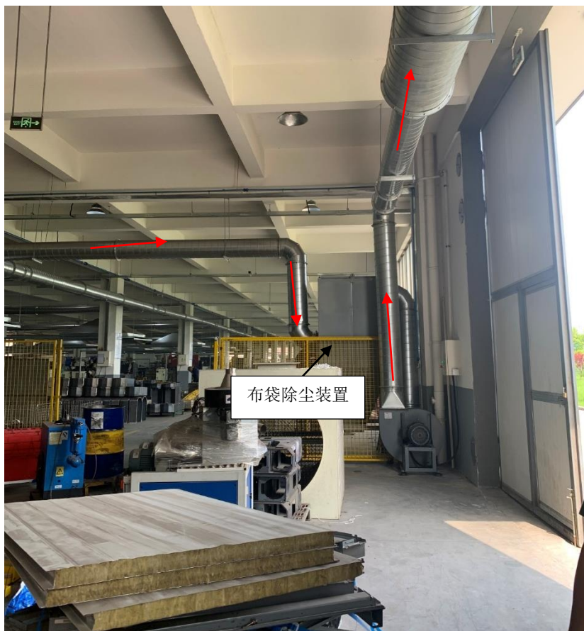
图4.1-9 切割、焊接、打磨废气布袋除尘装置照片
