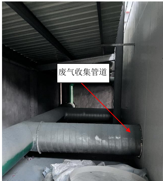
图 3-4 喷砂废气收集管道照片
