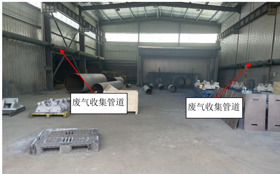
图 3-2 喷漆、晾干废气收集管道照片
