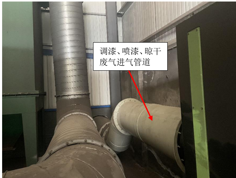
图 7-3 调漆、喷漆、晾干废气进气管道照片
