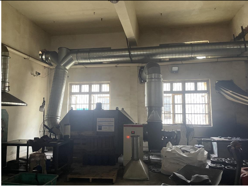
图 3-4 硫化、包覆配料、包覆废气处理设施照片
