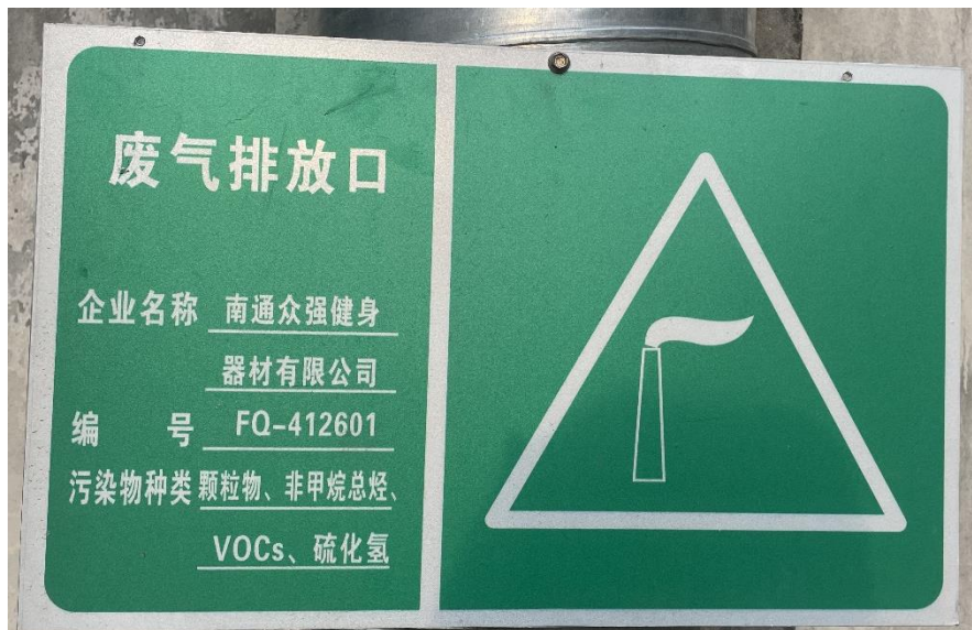
图 3-10 1#排气筒标志牌照片
