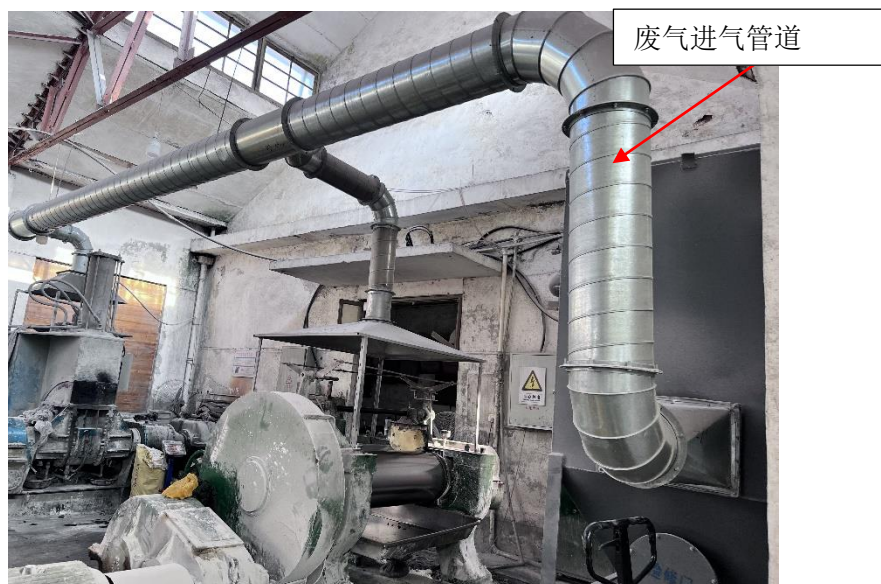
图 7-2 密炼、开炼废气进气管道照片
