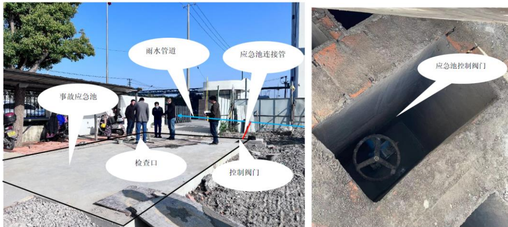
图 3-7 事故应急池及控制闸阀照片
