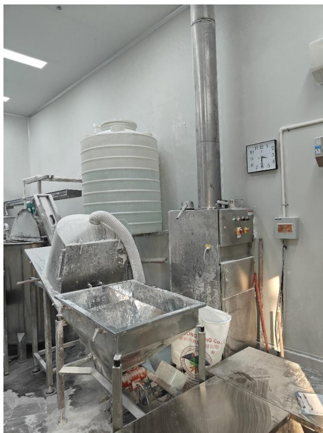
图 3-2 投料、搅拌废气集气罩收集装置及滤筒除尘装置
