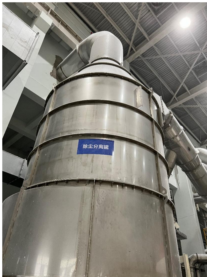
卷取废气湿式除尘系统照片
