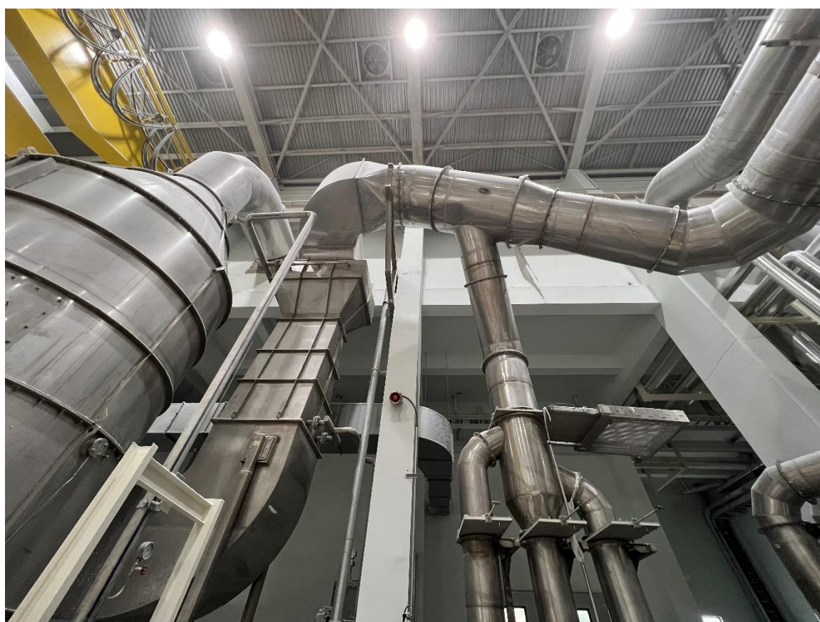
废气处理设施进口处照片
