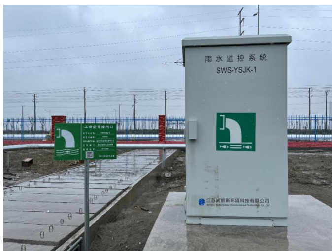
雨水排口自动监控系统照片
