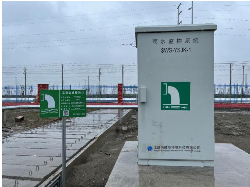
雨水排口自动监控系统照片
