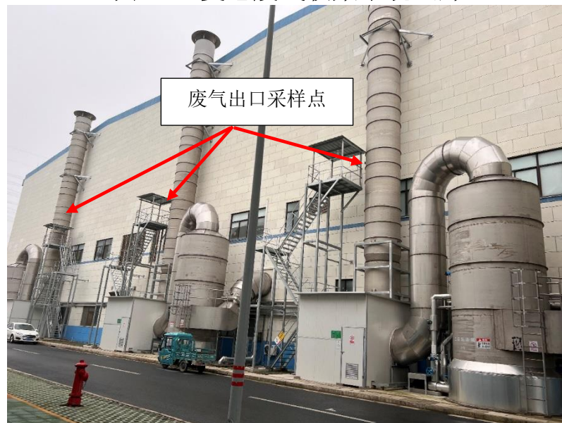
图4.1-4 复卷废气湿式除尘系统及排气筒照片
