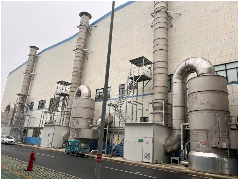
图7.1-2 废气处理设施进口处照片
