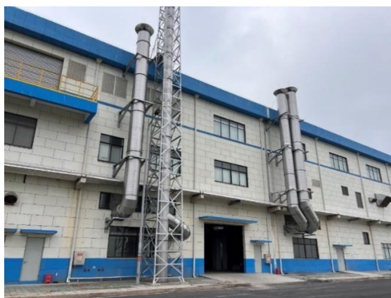
图 3-8 废气排口规范化照片
