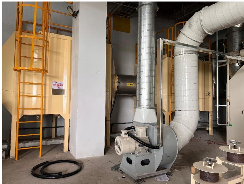
图 3-3 热熔胶加热废气二级活性炭吸附装置照片
