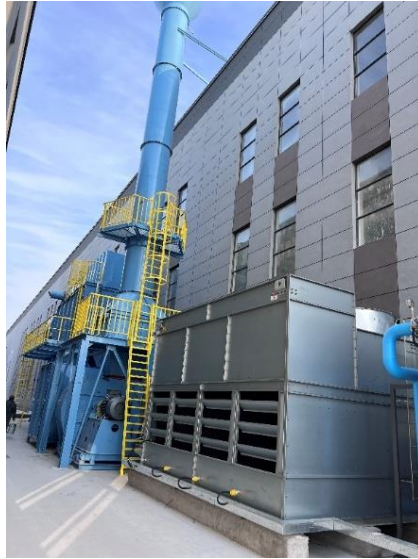
图 3-2 熔化、球化、造型、浇注、射芯废气布袋除尘装置+三级过滤器+活性炭吸脱附+催化燃烧装置及 DA001 排气筒照片
