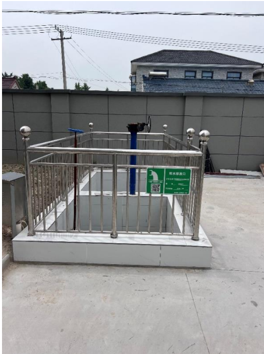
图 3-20 雨水排放口及标志牌照片
