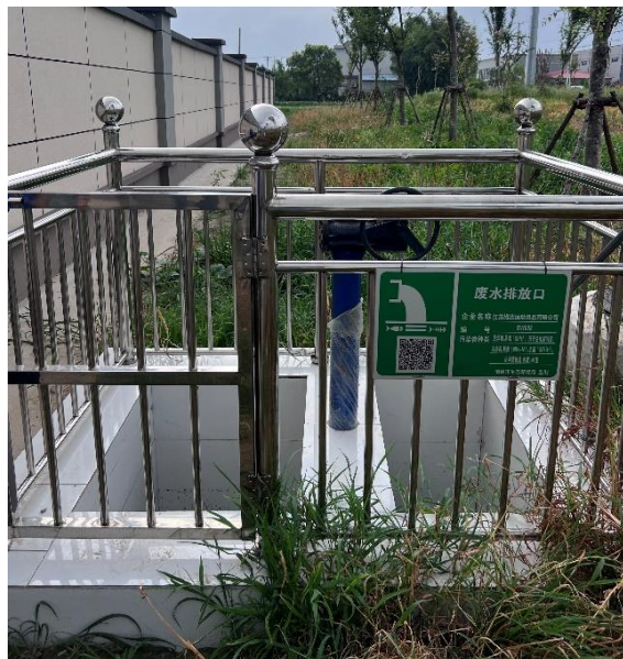
图 3-19 废水排放口及标志牌照片
