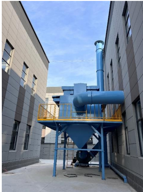
图 3-6 清砂、抛丸、打磨废气布袋除尘装置及 DA006 排气筒照片
