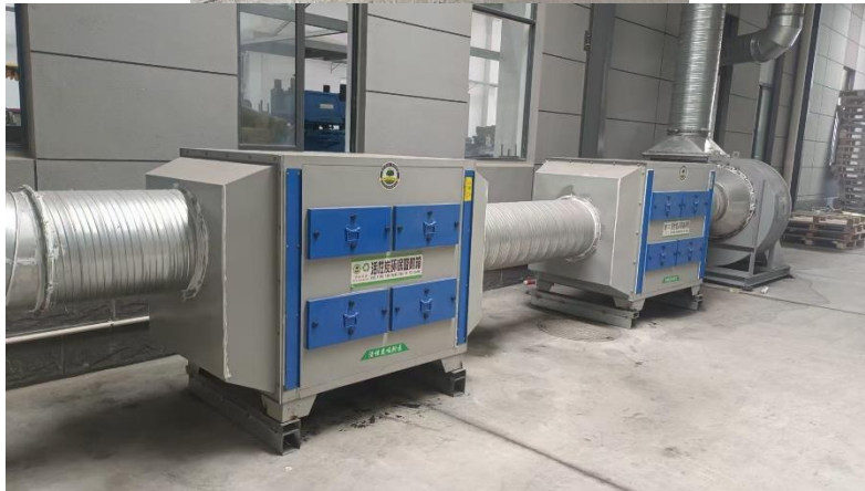
图 3-11 配料、密炼、开炼、硫化废气布袋除尘+二级活性炭吸附装置
