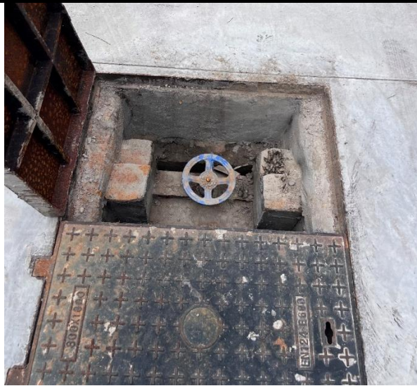
图 3-17 事故应急池及控制闸阀照片
