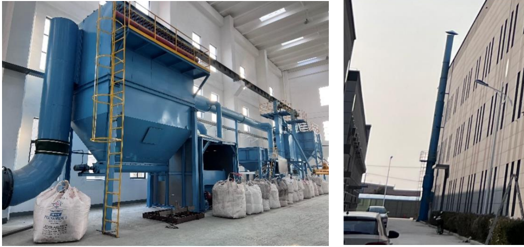
图 3-5 树脂砂混砂、破碎、落砂废气布袋除尘装置及 DA005 排气筒照片
