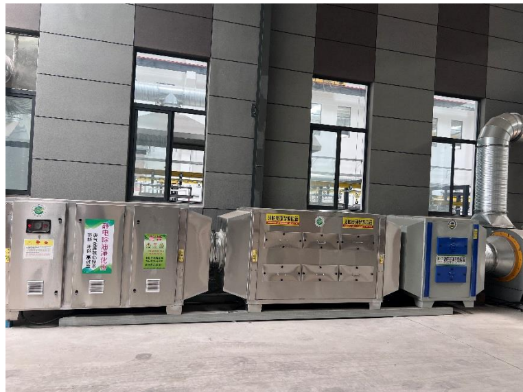
图 3-12 浸塑及烘干废气静电除油+除雾+二级活性炭吸附装置
