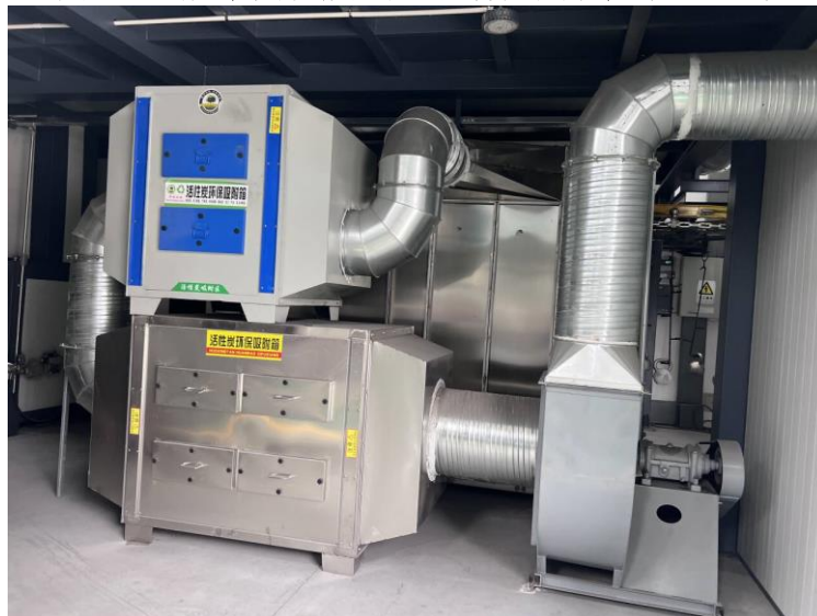
图 3-9 调漆、喷漆废气水帘装置+过滤棉+二级活性炭吸附装置照片
