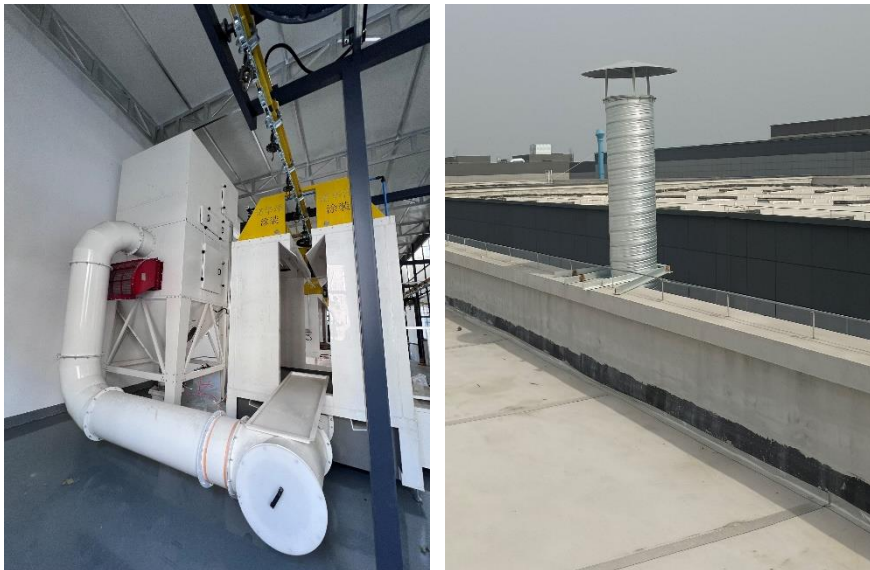
图 3-7 喷塑废气滤筒+旋风+布袋除尘装置及 DA002 排气筒照片
