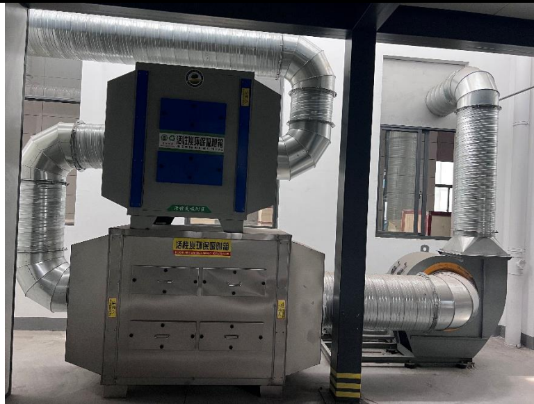
图 3-8 烘干固化废气二级活性炭吸附装置照片
