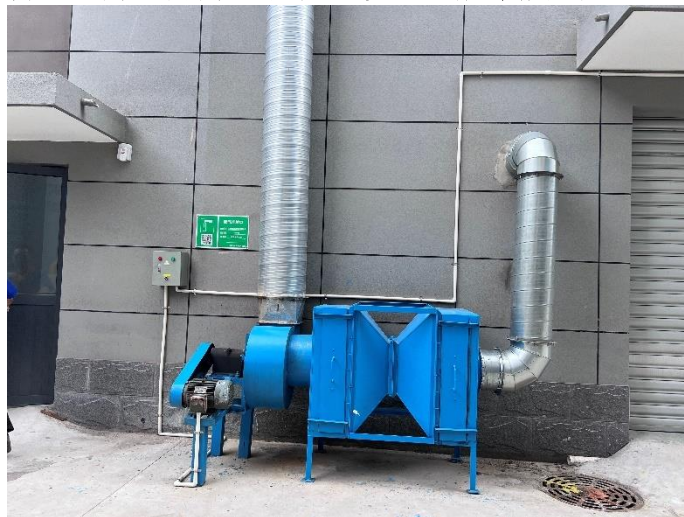
图 3-14 危废仓库废气二级活性炭吸附装置及 DA009 排气筒照片
