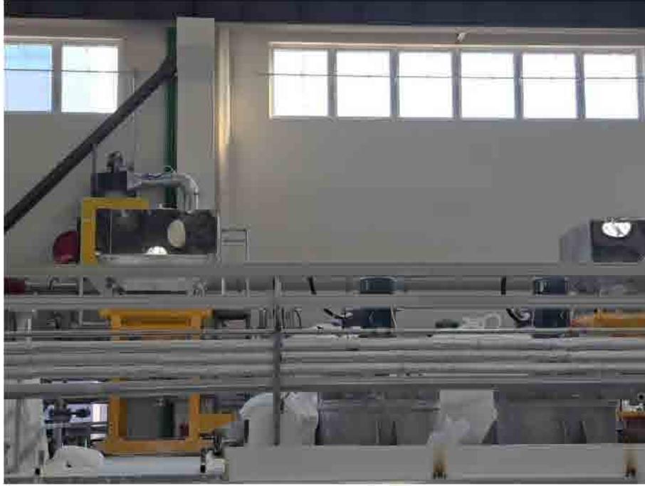
图 3-4 投料废气处理措施照片
