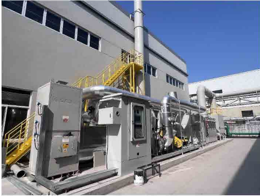
图 3-10 2#有机废气排气筒照片
