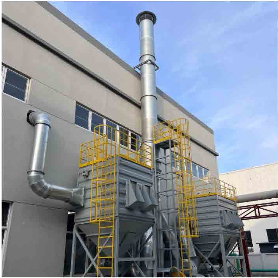
图 3-9 1#铣切、打磨、修边废气排气筒照片
