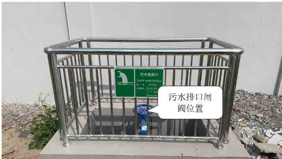
图 3-9 污水排口照片
