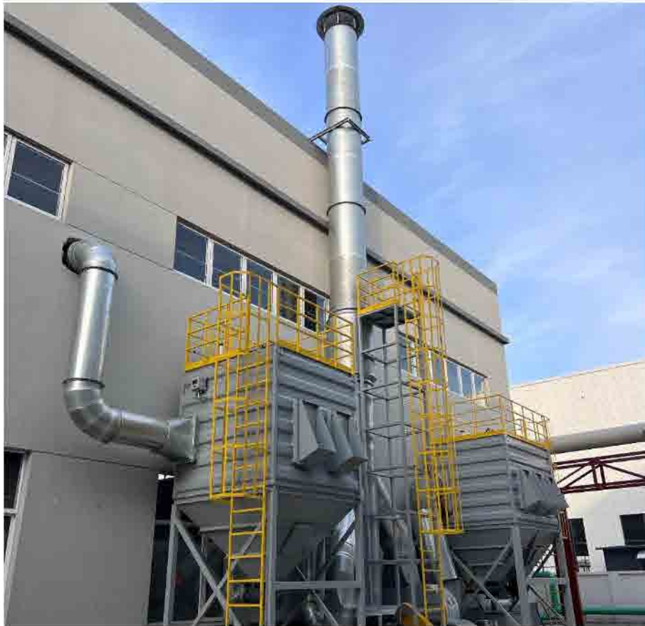
图 3-5 铣切、打磨、修边废气合并废气处理设施照片
