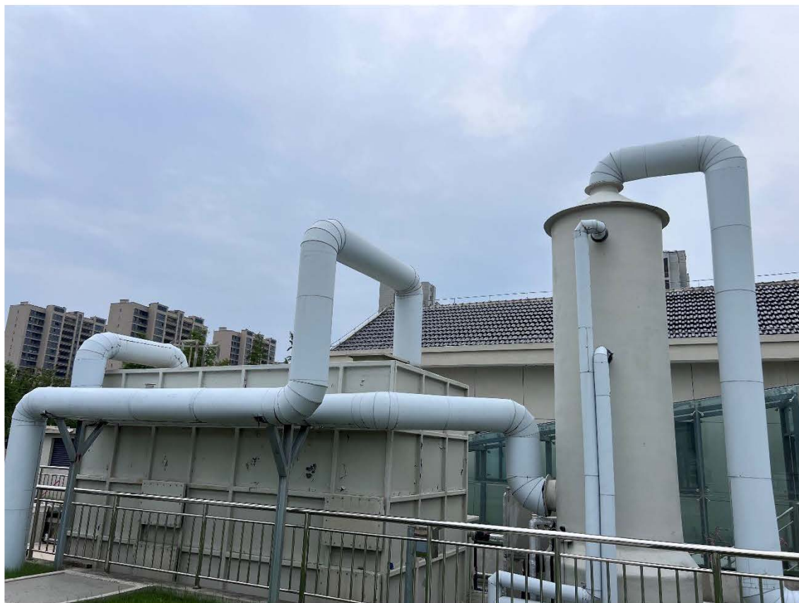
图 3-2 污水处理站废气管道照片
