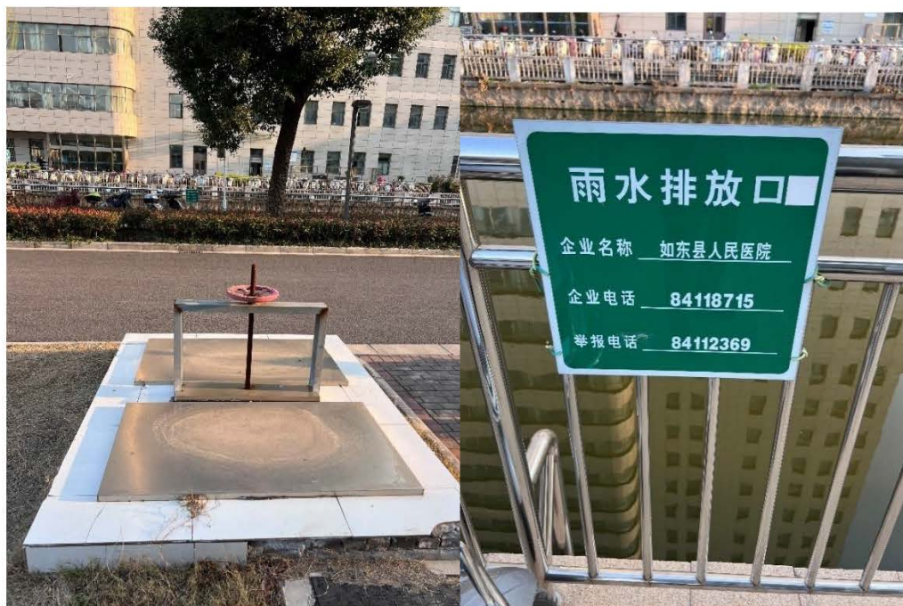
图 3-9 雨水排放口及标志牌照片
