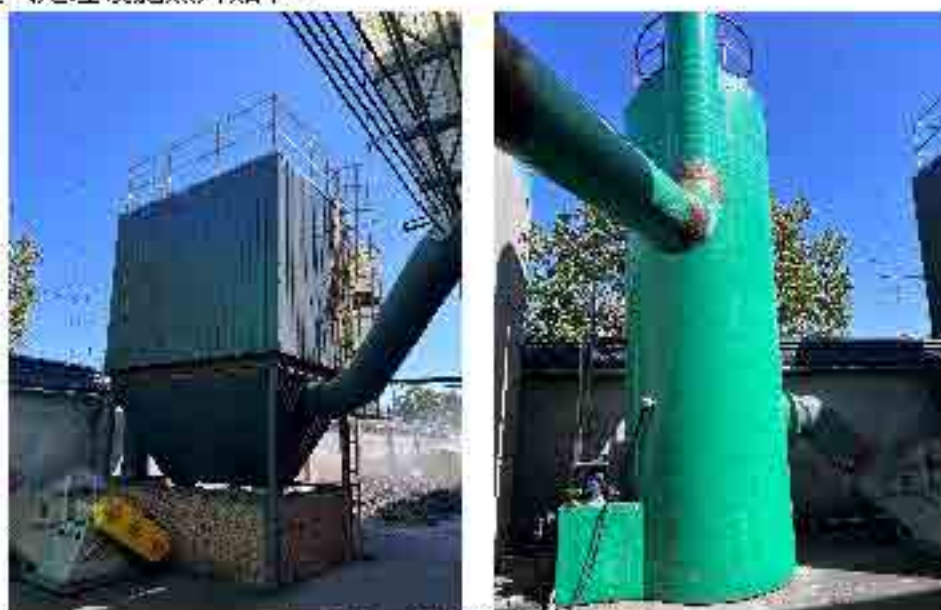
图 3-2 废气处理设施照片
