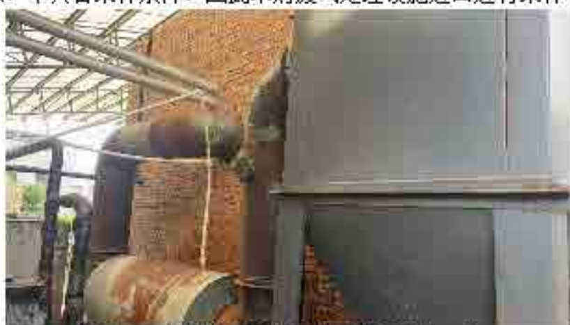
图 3-1 锅炉燃烧废气处理设施进口照片
