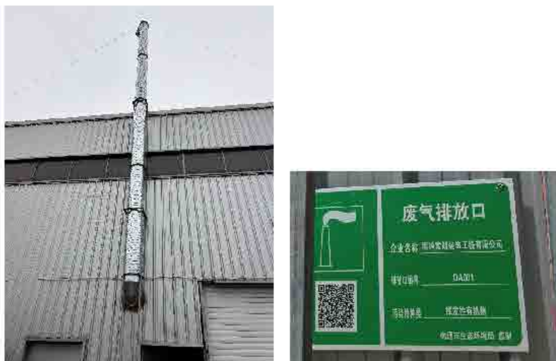
图 3-4-2 规范化排污口照片（废气排口）
