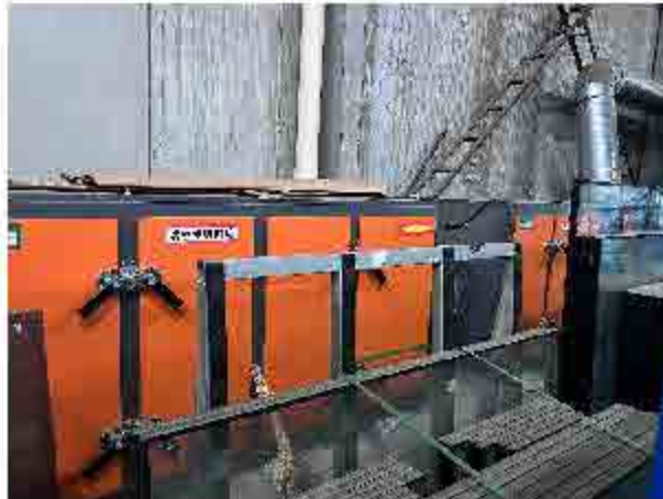
图 3-2 废气处理设施照片
