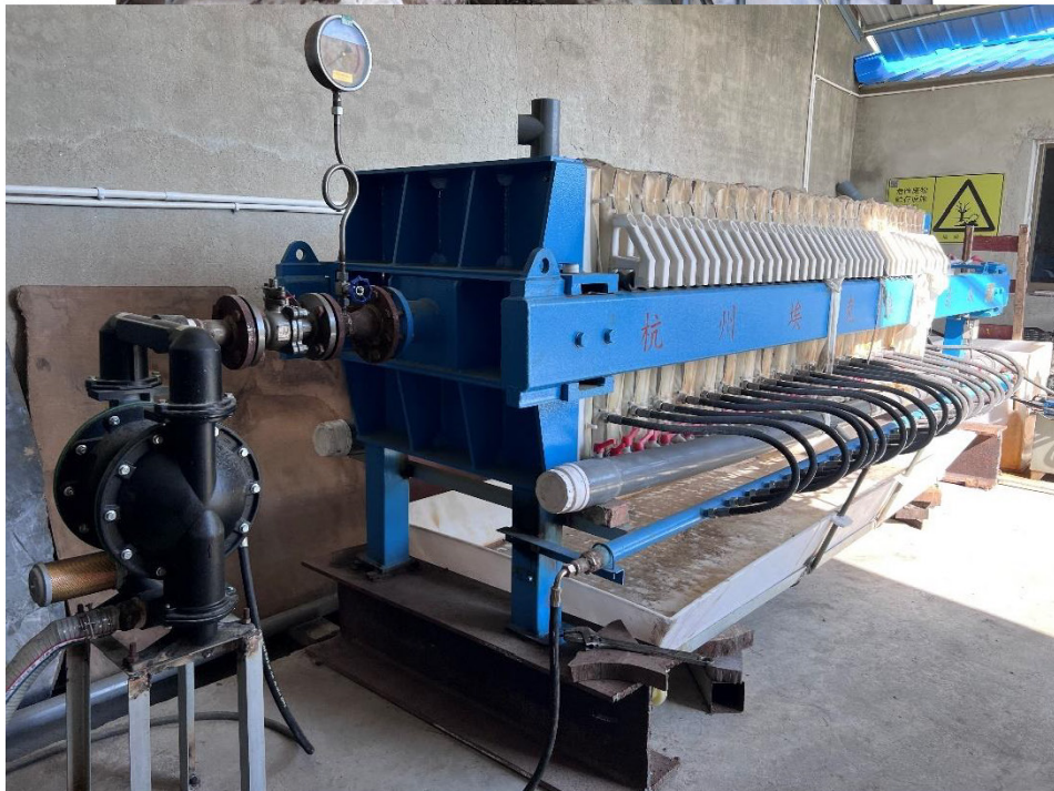
图 3-4 废水处理设施照片
