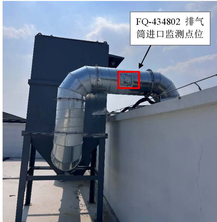
图 3-6 FQ-434802 排气筒进口监测点位
