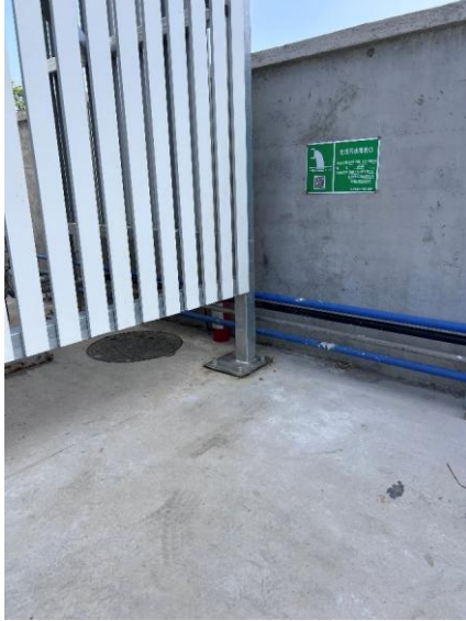
污水排口及标志牌照片
