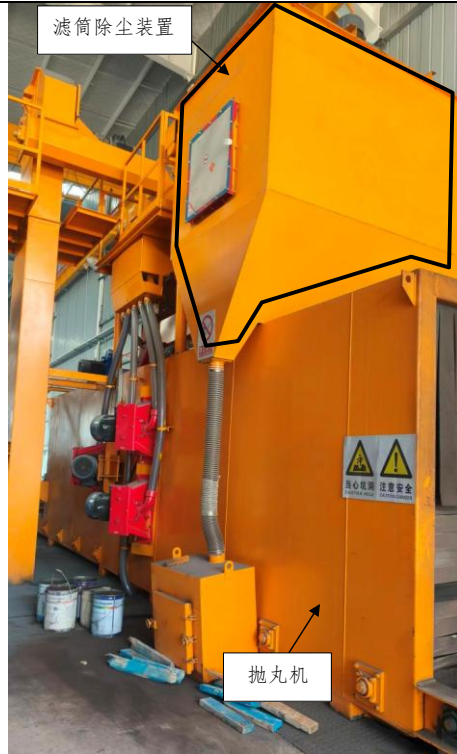
抛丸废气进口照片
