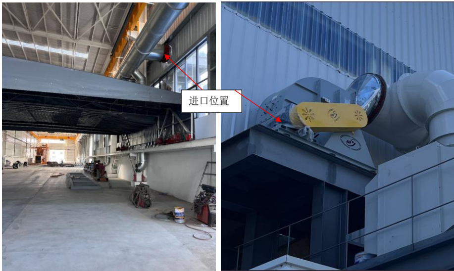
喷漆房、RTO装置以及危废仓库废气进口照片
