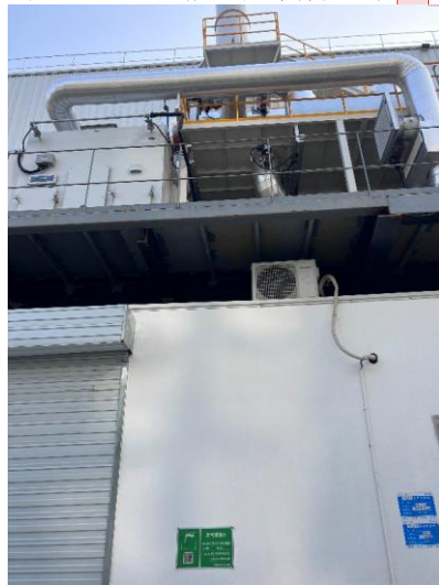
图4.1-4 喷漆房废气四级干式过滤+沸石转轮浓缩+RTO炉装置
