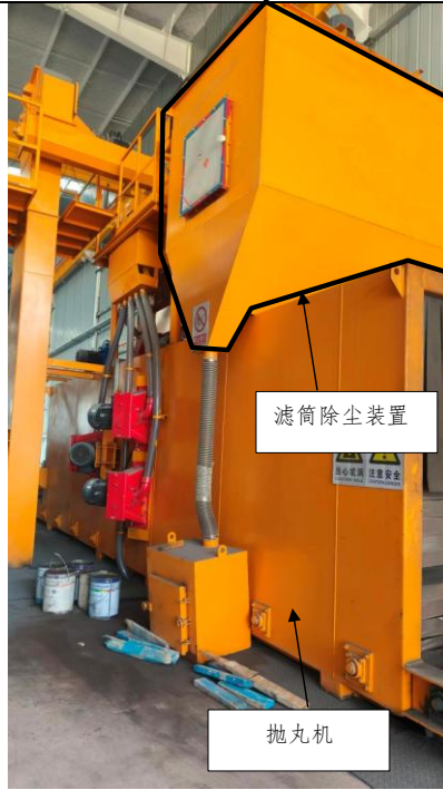
图4.1-3 抛丸废气滤筒除尘装置
