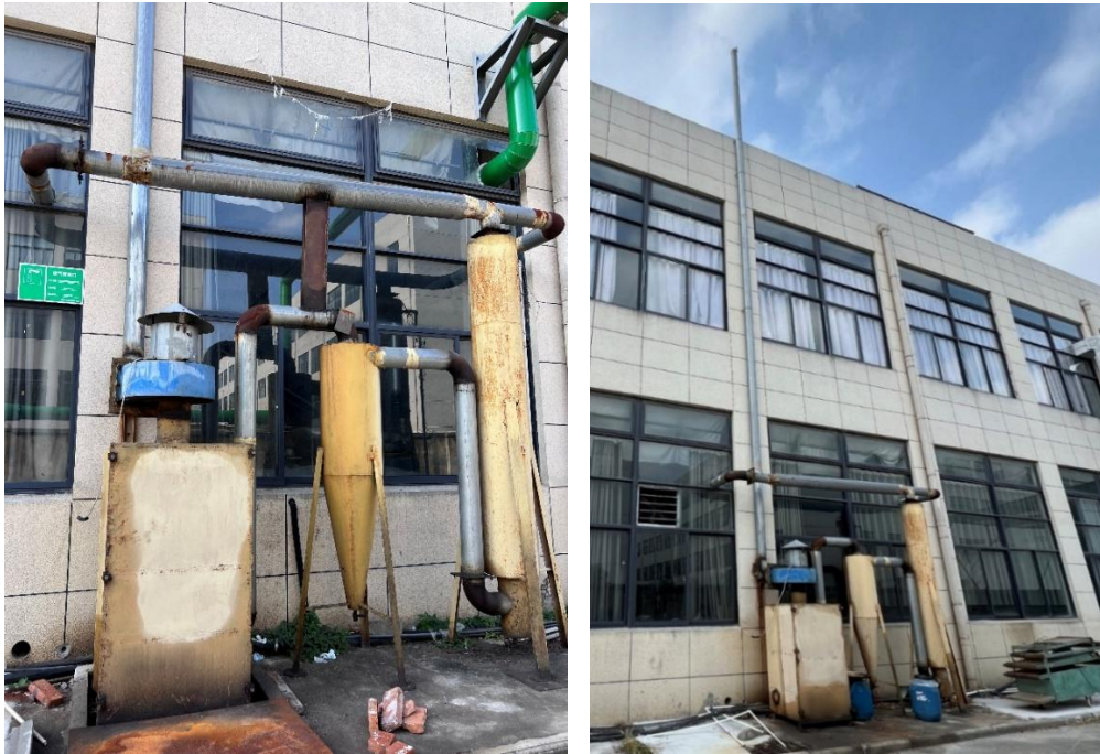
图 3-2 脱蜡、底涂烘干废气冷凝+气液分离+1#活性炭罐及 DA001 排气筒照片
