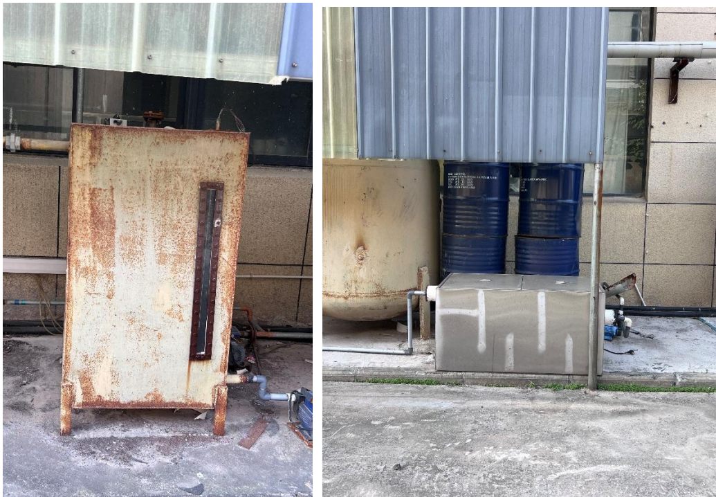
图 3-5 隔油池+油水分离器照片
