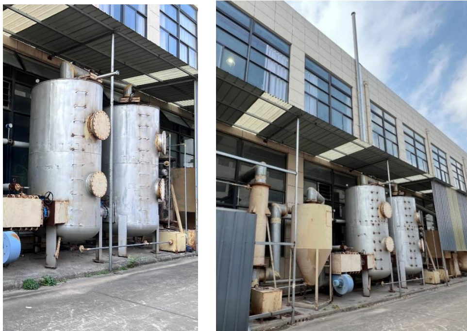
图 3-3 搅拌、涂布、烘干废气 2#、3#活性炭罐及 DA002 排气筒照片
