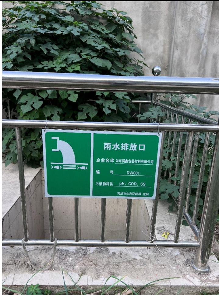
图 3-9 雨水排放口及标志牌照片
