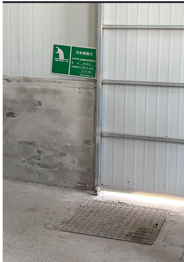
图 3-8 废水排放口及标志牌照片
