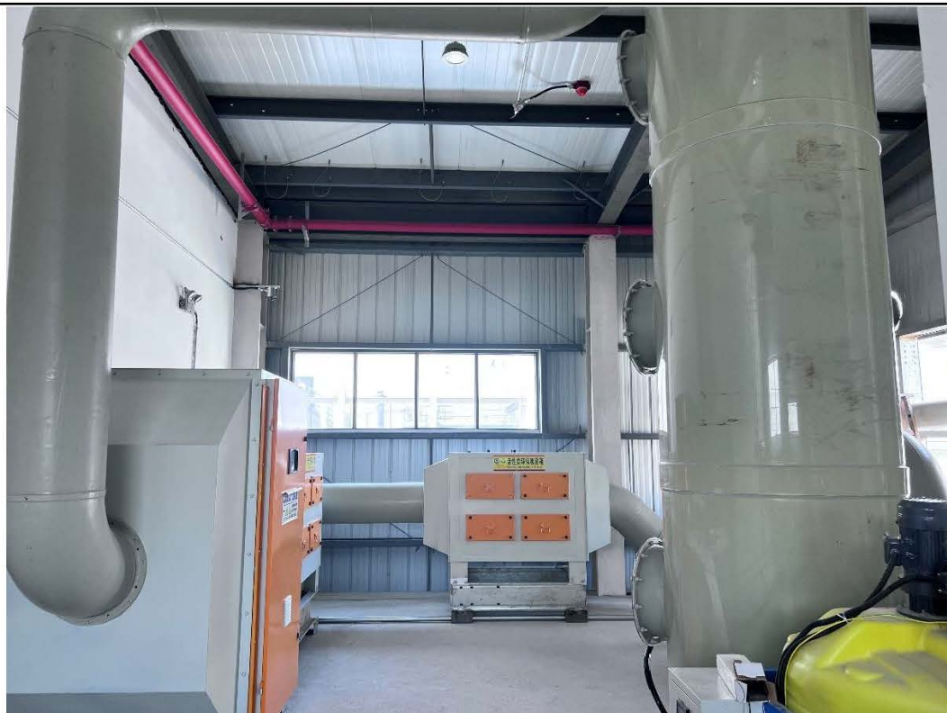
图4.1-4 次钠吸收+碱吸收+气雾分离器+三级活性炭吸附装置
