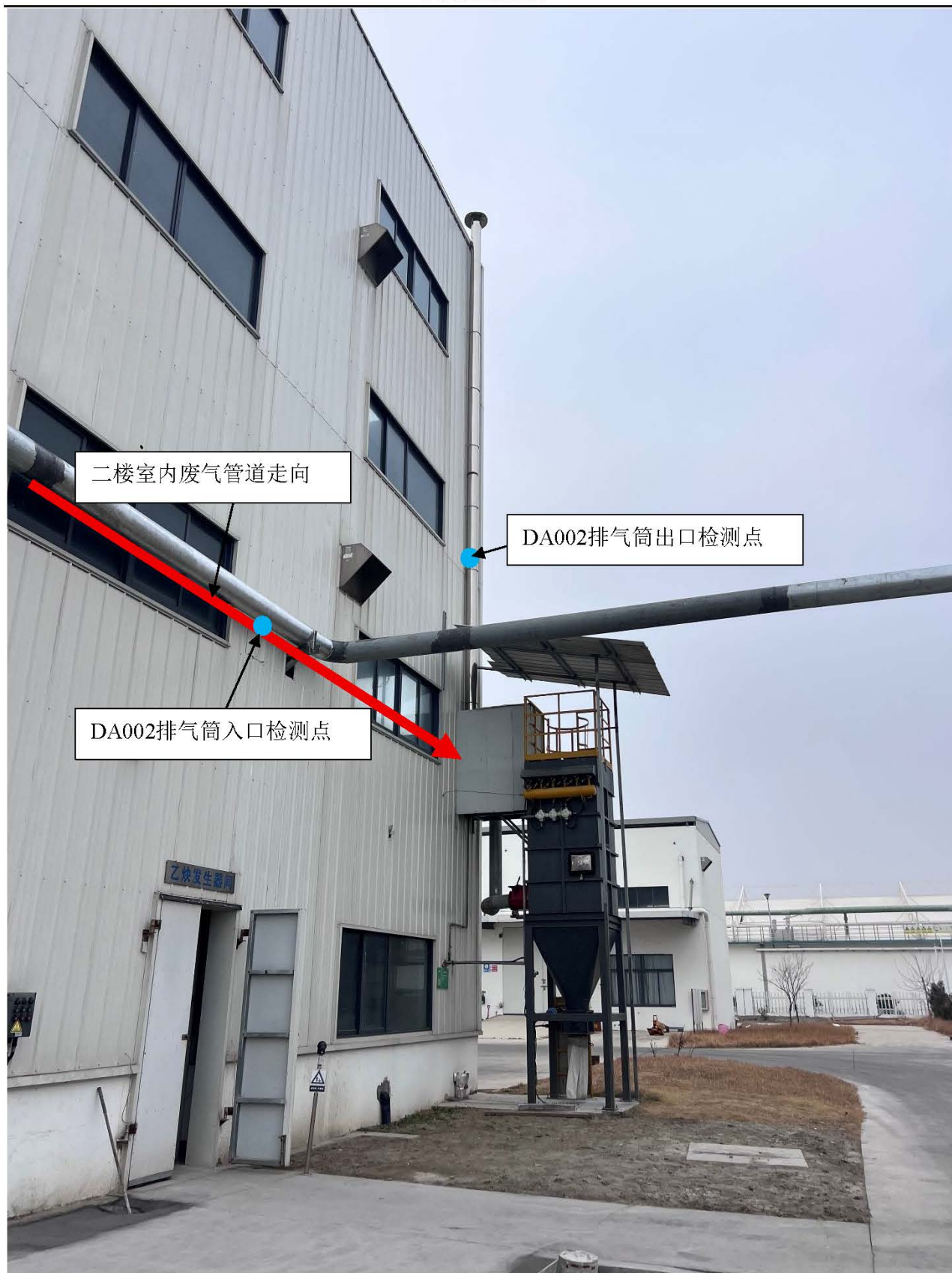
DA002电石粉尘排气筒进出口照片
