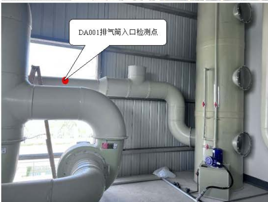
DA001渣水收集池、乙炔气体充装逸散及除锈补漆废气进出口照片
