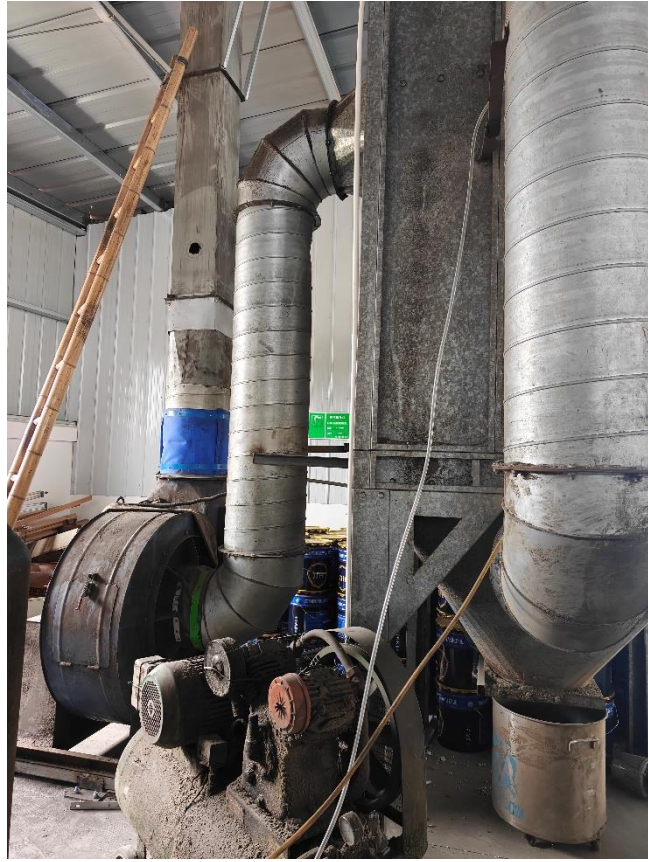
图 3-10 1#切割废气排气筒（编号：FQ-356801）照片
