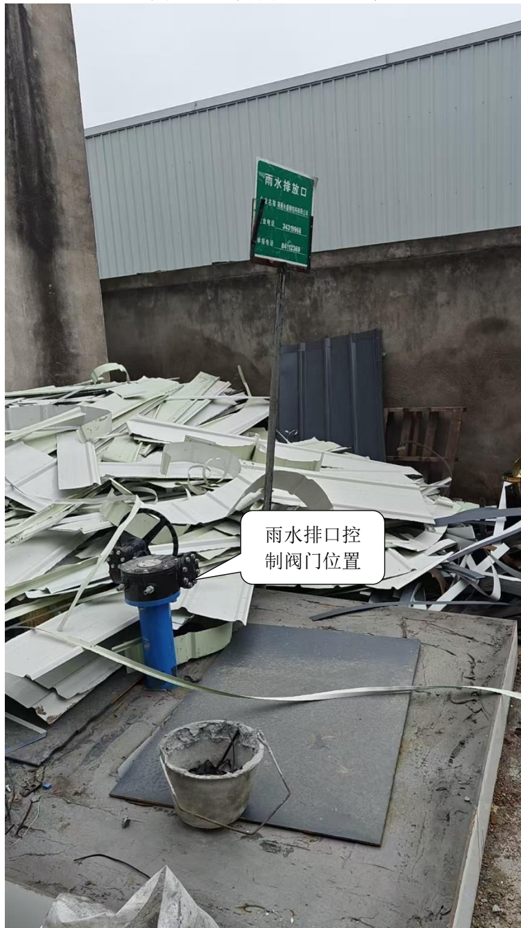
图 3-8 雨水排口照片
