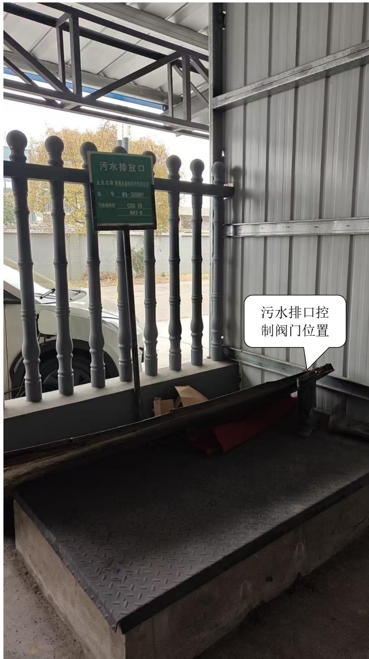
图 3-9 污水排口照片
