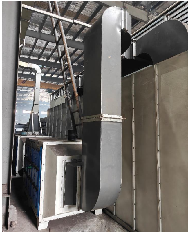
图 3-5 喷漆、晾干废气处理设施照片
