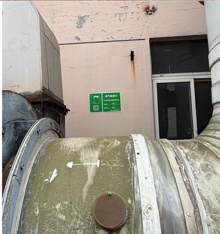
图 3-3 酸洗废气碱喷淋装置及 DA002 排气筒照片
