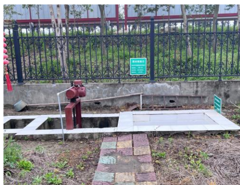
图 3-13 雨水排放口及标志牌照片
