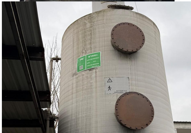
图 3-2 1#铁链条车间焊接废气、模具淬火废气油雾净化装置+水喷淋装置及 DA001 排气筒照片
