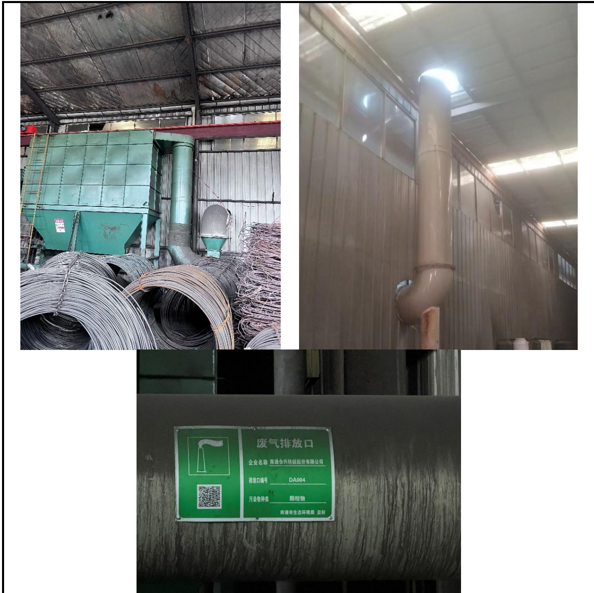
图 3-5 抛丸车间抛丸废气布袋除尘装置及 DA004 排气筒照片
